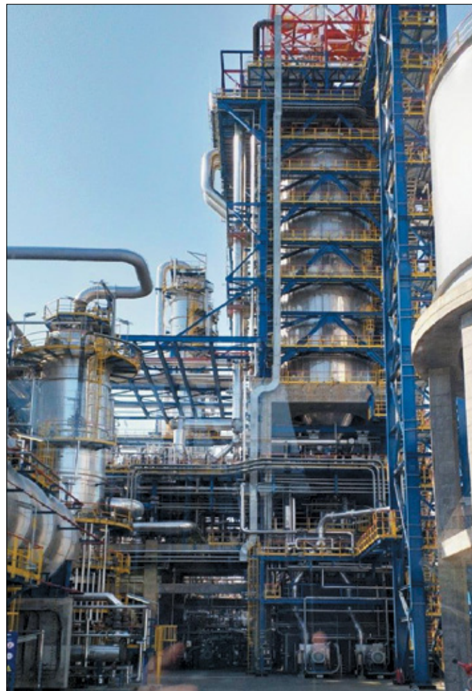
Rysunek 3. Fotografia instalacji technologicznej w rafinerii Figure 3. Photo of a technological installation in a refinery
